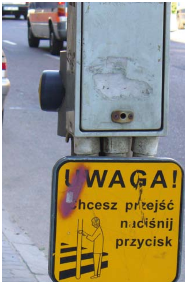
Warszawa, ul. Okrzei. Przycisk tylko po lewej stronie przejścia; na wysokości 140 cm (za wysoko); ukryty za słupem i skrzynką połączeniową; tabliczka poniżej przycisku; większa część obudowy koloru czarnego. (TR)
