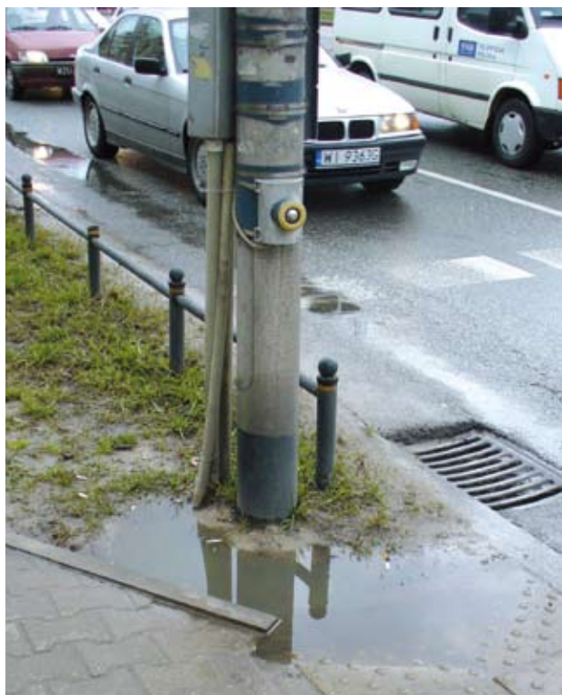
Warszawa, Woronicza przy TVP. Wysokość przycisku: 95 cm (za nisko); za daleko i oddzielony od pieszych błotem; tylko z lewej strony przejścia; boki nie kontrastują z podłożem; brak opisu przeznaczenia przycisku; ostre opaski w jego otoczeniu. (TR)
